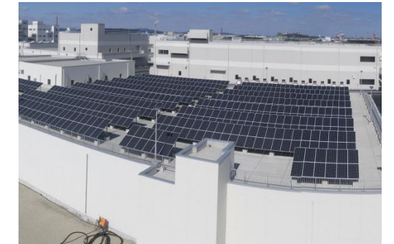
南蒲生浄化センターに設置している太陽光発電のパネル
