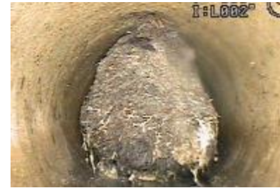
木の根による詰まり （木の根除去前）
