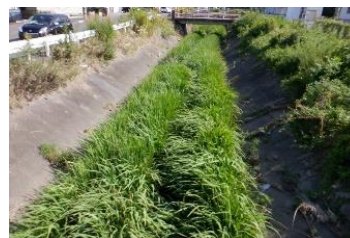
水路土砂堆積状況
