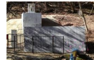
朴沢小水力発電所
