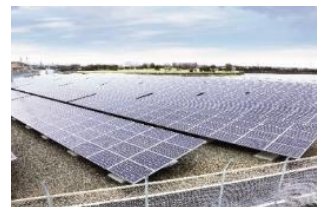
大沼太陽光発電所
