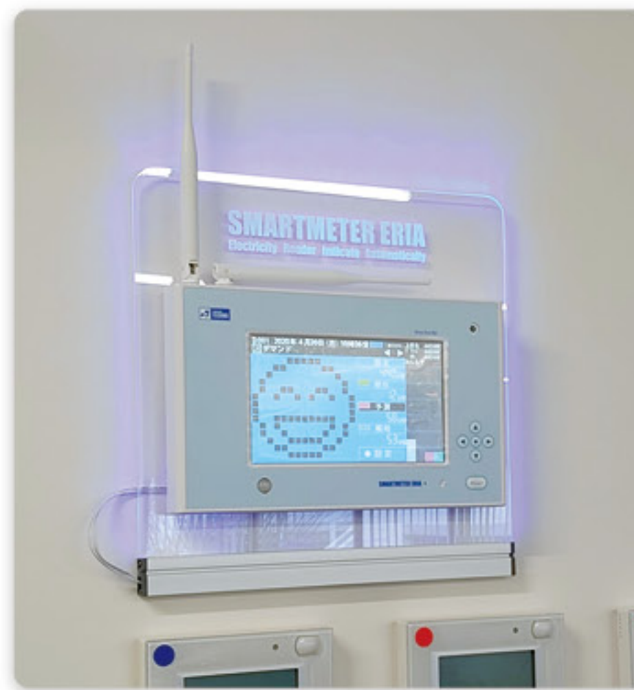
デマンド監視装置
