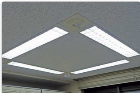
LED照明の採用
