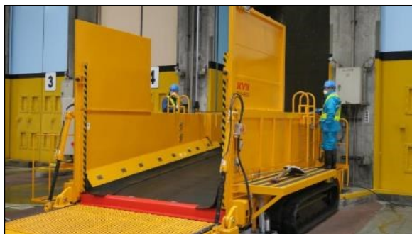
▲搬入物検査装置
