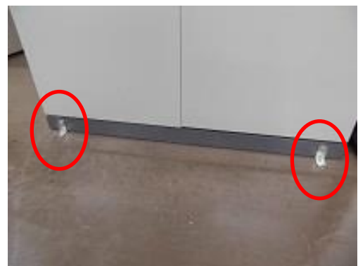
▲ 書棚の転倒防止対策の例
