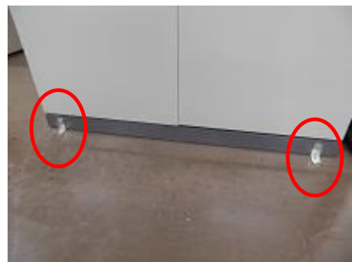
▲ 書棚の転倒防止対策の例
