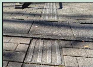
例：バリアとなる歩道上の段差 コントラストが不明瞭な誘導ブロック
