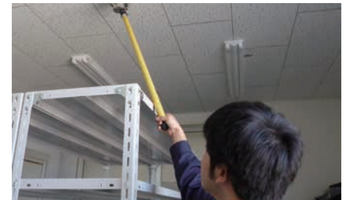
消防設備を点検している様子
