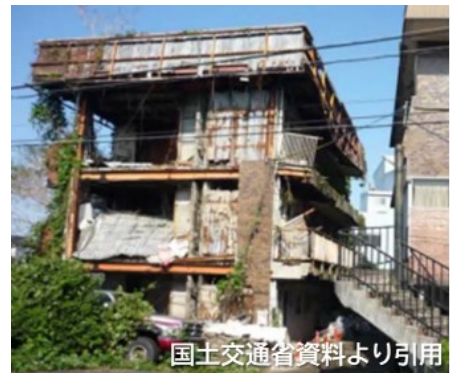
▲管理が適切に行われず、外壁等が崩落した他都市のマンションの事例 国土交通省資料より引用
