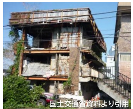
▲管理が適切に行われず、外壁等が崩落した他都市のマンションの事例
