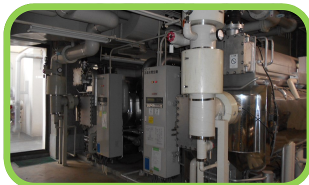
▲ 庁舎の冷房・暖房を行う冷温水発生機の維持管理も、総務課の仕事です
