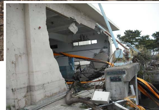
高砂南部排水機場
