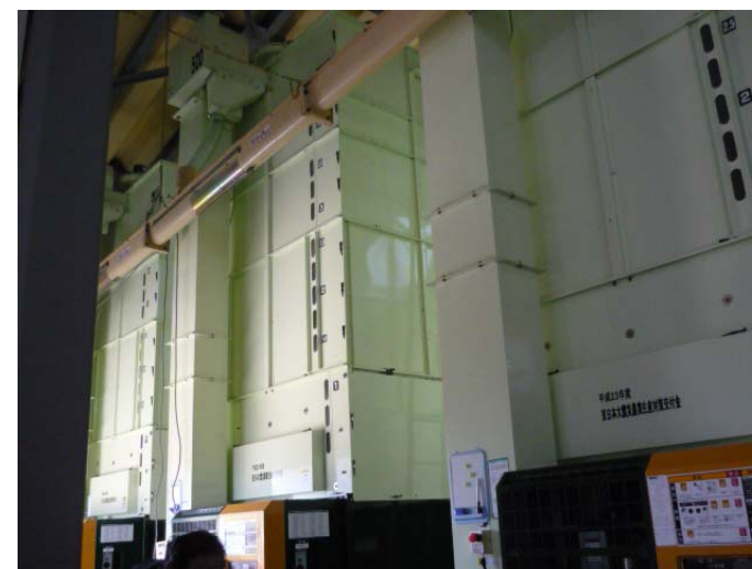
乾燥調整施設
