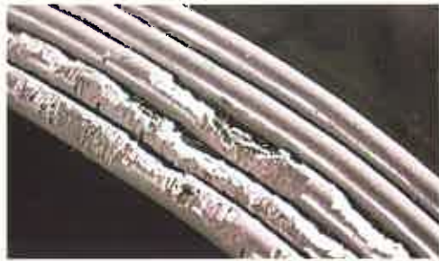
かじられた電気コード（写真提供：ねずみ駆除協議会）
