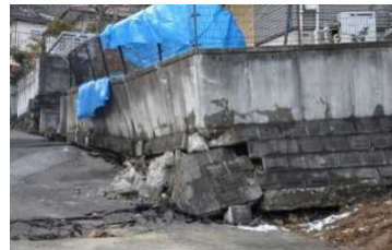
▲内陸部の擁壁被害(青葉区折立)
