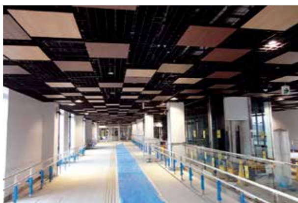
▲荒井駅1階コンコース。木目調パネルの間に照明を配置し、居久根の木々の下を歩くイメージを演出。エレベーターはガラス張りで、空間に広がりや奥行きを感じさせます
