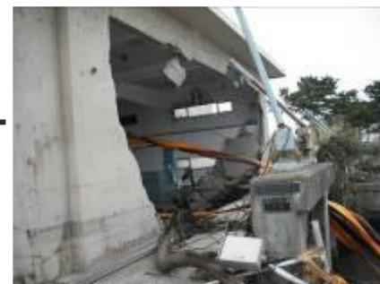
高砂南部排水機場
