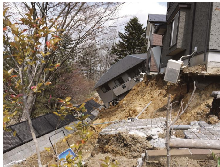
宅地被害（青葉区西花苑）
