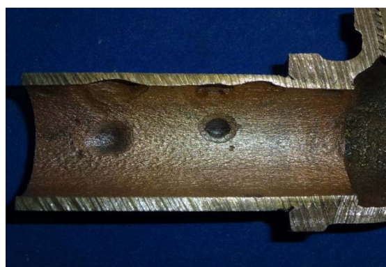
空調設備配管内部の状況
