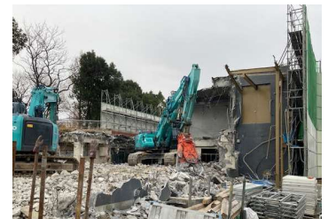
右の写真 → 飼料室部分の解体が終わり、 アフリカ園売店の壁を壊し はじめています。
