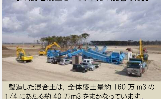
【津波堆積土とコンクリート塊の混合状況】
